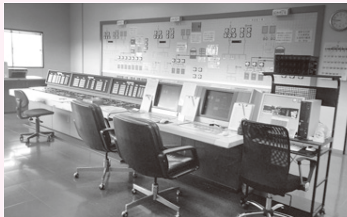
中央配水場の制御室
