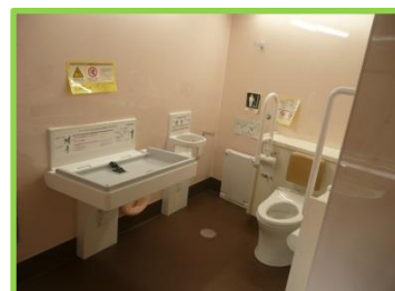
多目的トイレ（長岡京市）
