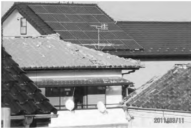
東日本大震災で被害を受けた家屋
