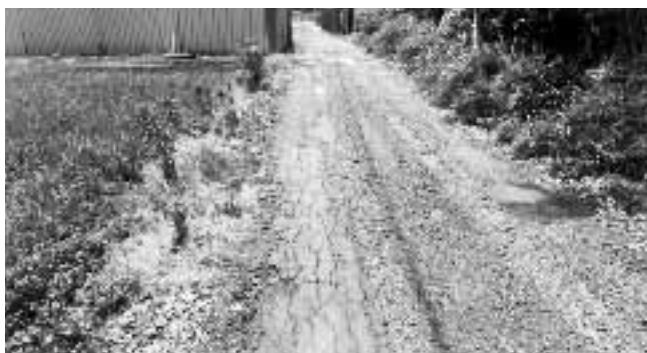
町道の延伸や改良、排水事業等の整備が待たれる（星の宮地区）
