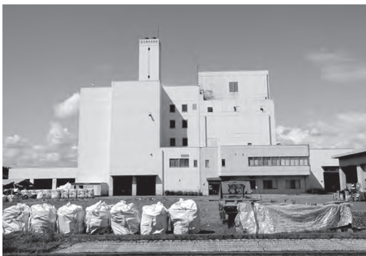
基幹的設備改良工事が行われている壬生町清掃センター
