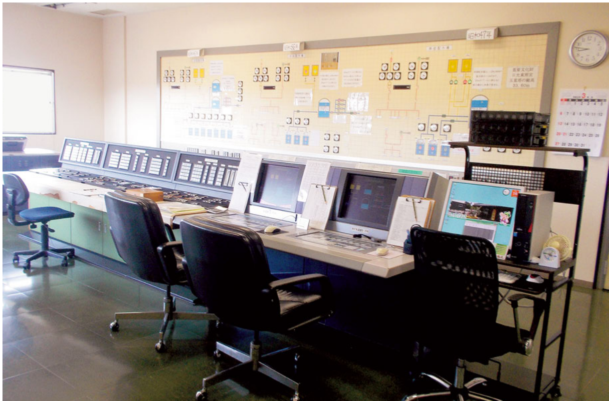
中央配水場制御室
