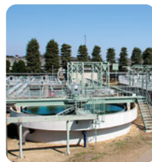
水処理センター
