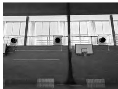
中学校体育館空調 (スポットクーラー)
